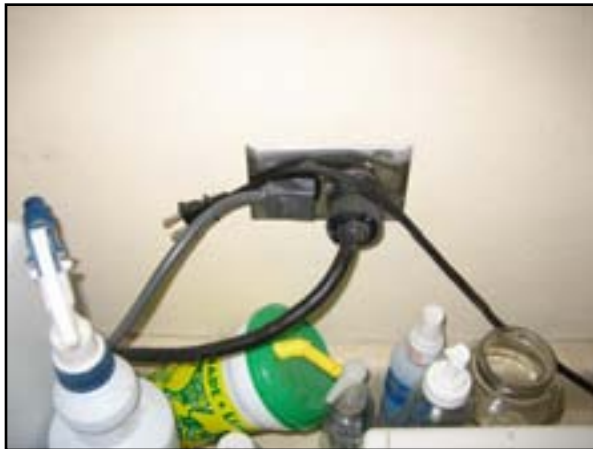
Wiring Devices: Insuficient Receptacles
