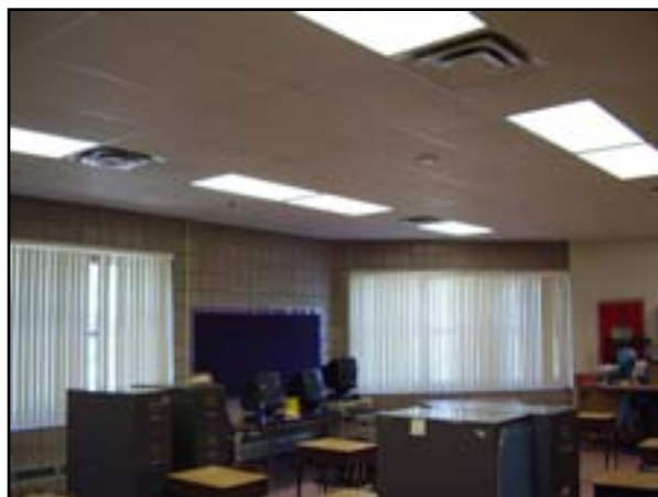
HVAC: Add Dehumidification 1994
